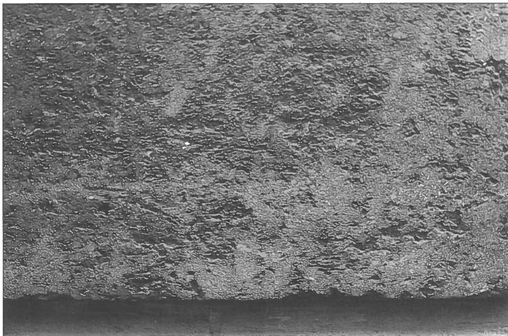
3 . Auparavant lisse, cette pierre fait apparaître après ravalement toutes les parties internes plus dures : coquilles, fossiles, bancs, etc. Presque tous les immeubles parisiens du XIXème siècle subissent ce type de dégradation.
